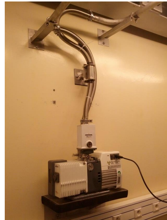
Système de pompage déporté
