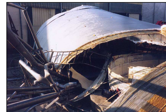
Effondrement d'une cuve
